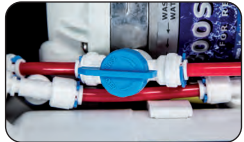
Spülventil offen, Vorfilter wird gespült.
